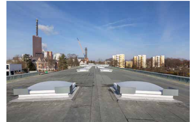
Lagerhalle Dachdecker 1kauf Ost eG, Berlin Sanierungs-Rauchabzug fumivent® 4000 Lichtkuppel essertop® eckig Flachdachfenster essersky® eckig
